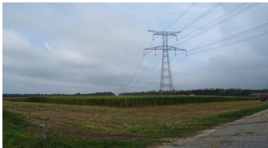
Ligne haute tension
