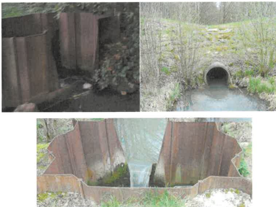
Figure 72 : Bassin d'orage à Dollot, palplanche, buse et digue en terre - Dollot (89) - ORVANNE
